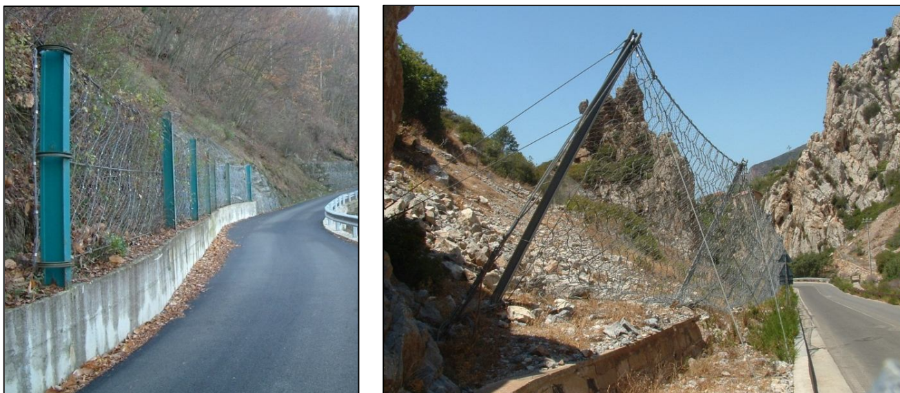
Fig. 123 – Barriere paramassi elastiche: verticale a sinistra e a sacco a destra.
