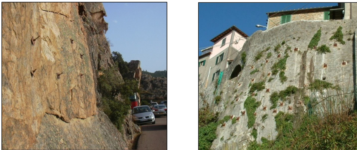
Fig. 89 – A sinistra utilizzo di bulloni per la stabilizzazione di una lastra di granito. A destra consolidamento di una parete rocciosa tramite bullonatura
