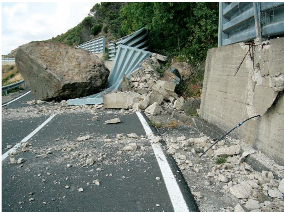
Fig. 130 - Punta Spinosa Strada Statale n°134 (tratto Castelsardo-Sedini) blocchi di Ignimbrite (fino a 50mc) hanno invaso la sede stradale dopo aver rotolato sul versante per circa 100 m, aver travolto il muro di cemento armato e la barriera paramassi (Progetto IFFI).
