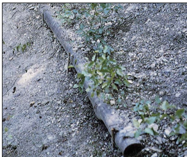
Fig. 28 – Particolare di una palizzata realizzata per la stabilizzazione di una scarpata stradale. In questo caso i pali trasversali sono fissati direttamente a tondini di acciaio infissi nel terreno; nel gradone a tergo dei pali trasversali sono state messe a dimora piantine in fitocella (da REGIONE LIGURIA, 1997).
